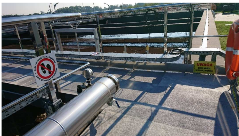
Oznakowanie na reaktorze biologicznym.
