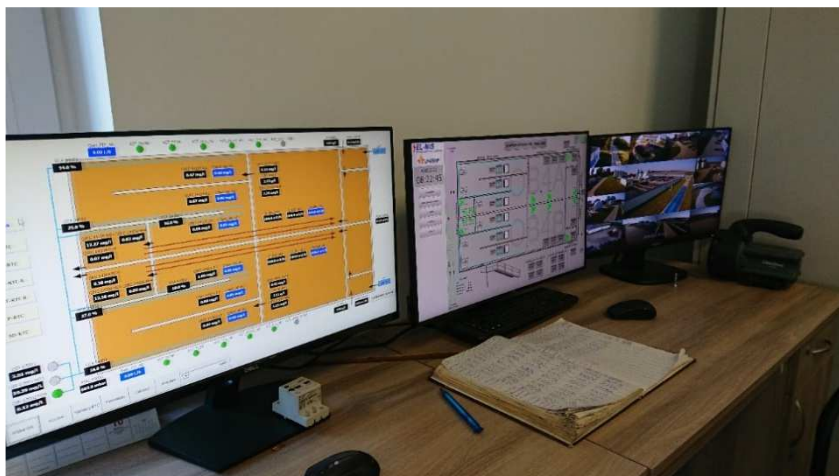
Pomieszczenie dyspozytorni. Pulpity sterownicze oraz monitoring obiektu.
