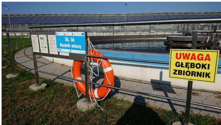
Oznakowanie i instrukcje przy osadniku wtórnym.
